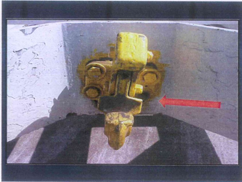
Enganche en mal estado
