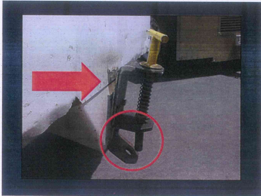
Enganche en mal estado.
