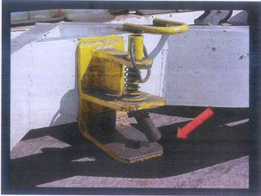
Enganche en mal estado.
