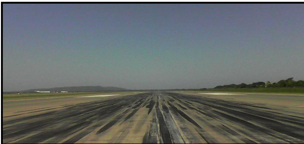
Fig. 1.1 Acumulación de Caucho 17°32' 43.4" N 88°20'45.2"W
