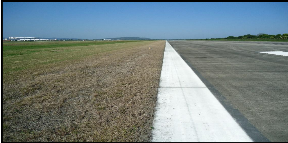
Fig. 1.2 Margen sin mantenimiento. 17°32' 43.4'' N 88°20'45.2''W
