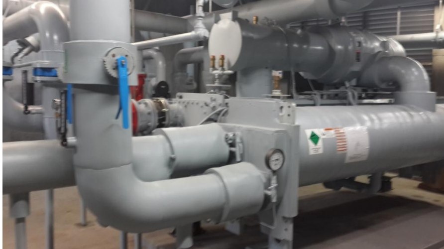
Tubería del Chiller
